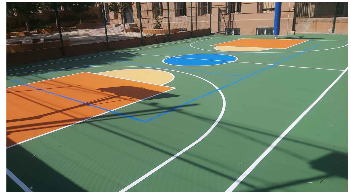
6_FRESAT I COL·LOCACIÓ DE NOU PAVIMENT DE RESINES AMB ÀREES I LÍNIES PINTADES
