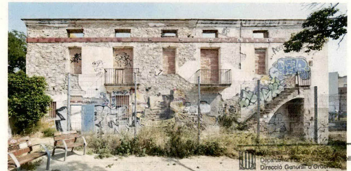
Imatge 10. Can Carol estat actual. Façana sud. Juny 2017. Font: Oliveras Boix Arquitectes
